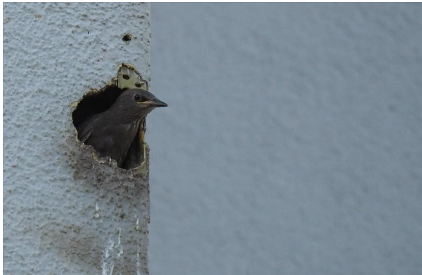
Foto 42. Juveniler Star an einem der als Brutplatz genutzten Hohlräume in der Fassade des Hotelgebäudes im Osten des UGs.
